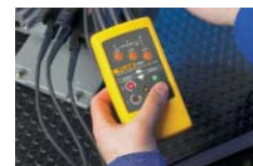
Moottoreiden pyörimissuunnan tarkistaminen ennen varsinaista kytkentää.
