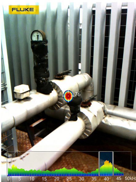
Putkiston vuotojen havaitseminen
